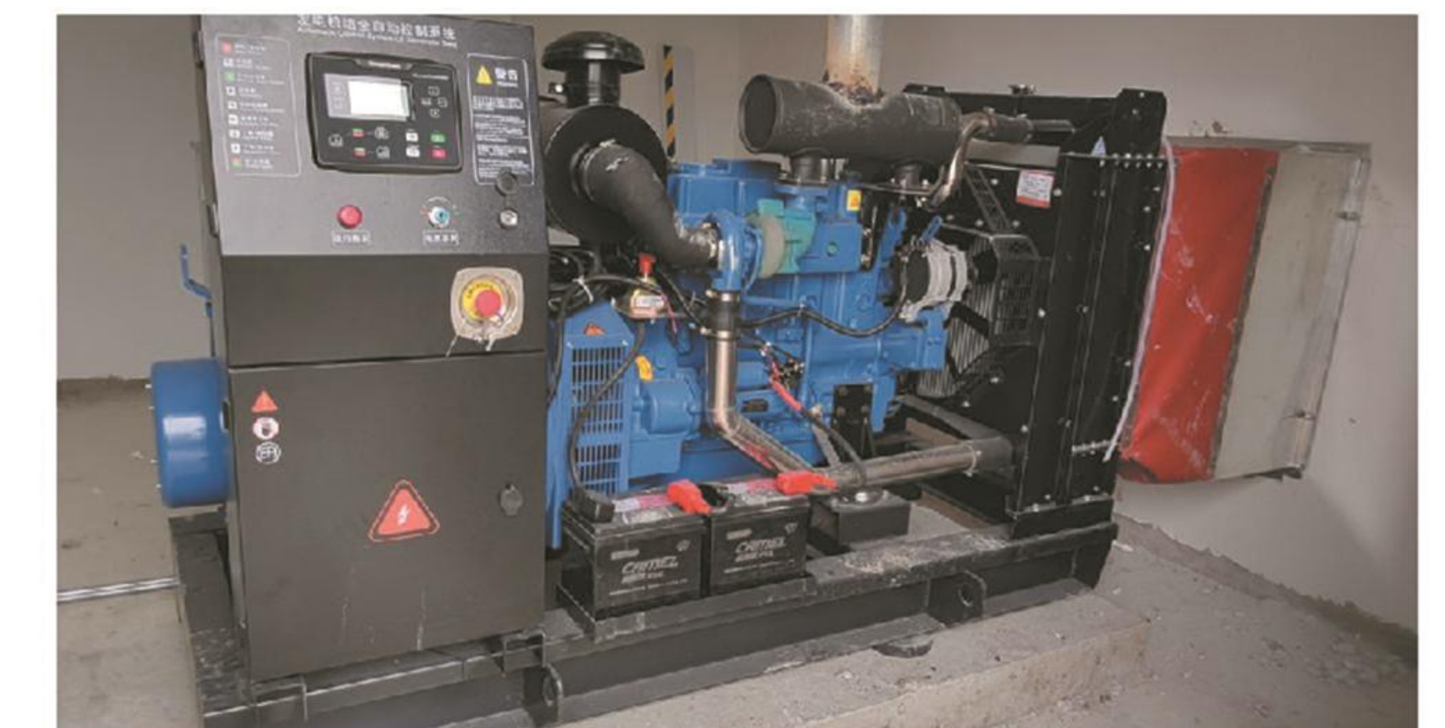
Công ty TNHH Kỹ thuật Xây dựng Dự Mân YUCHAI 125kVA
