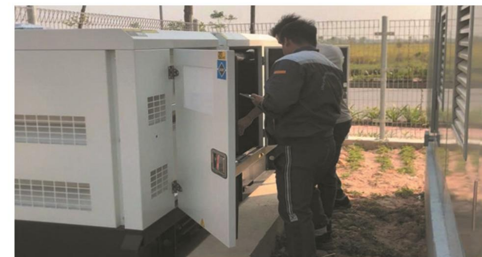
CÔNG TY TNHH OPTRONTEC VINA YUCHAI 63kVA
